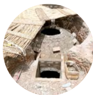
Biodigesteurs installés dans la boucle du Mouhoun
